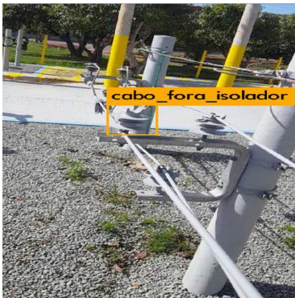
Figura 38 – Detecção Cabo Fora do Isolador
