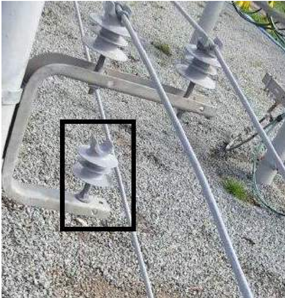
Figura 34 – Cabo fora do Isolador
