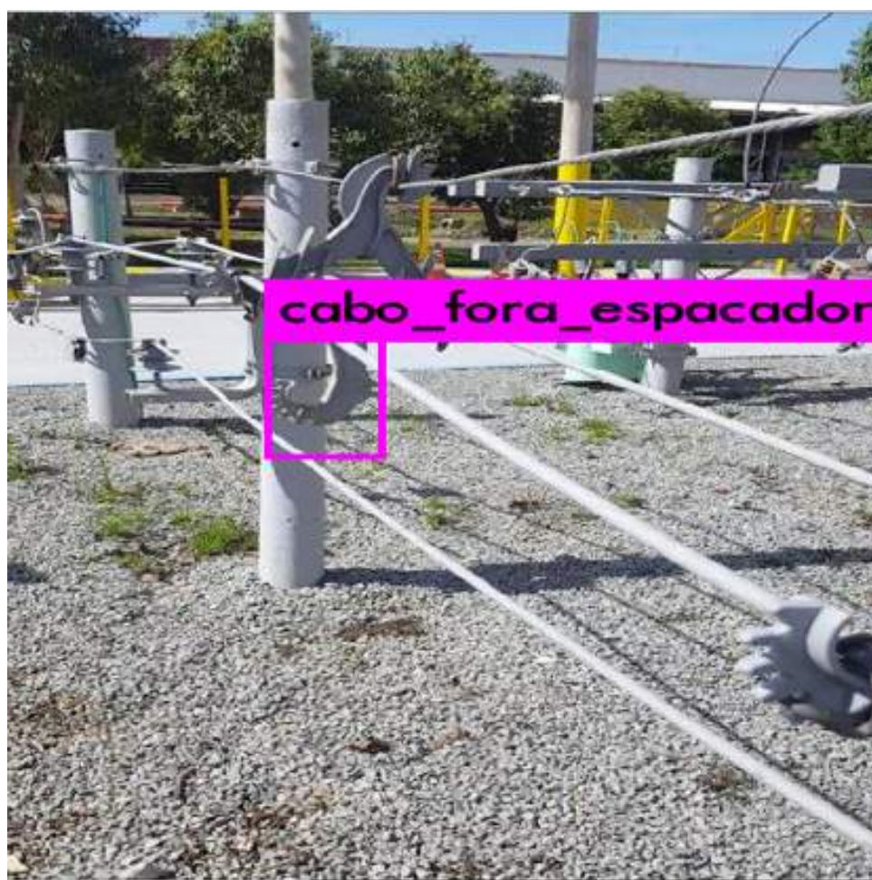
Figura 39 – Detecção Cabo Fora do Espaçador
