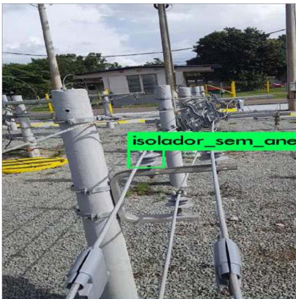
Figura 40 – Detecção Isolador sem Anel de Amarração
